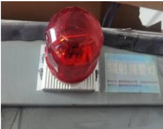
铅房辐射报警灯
