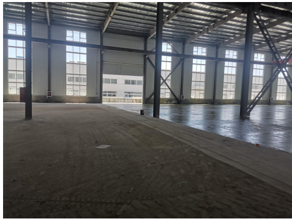
生产车间内部
