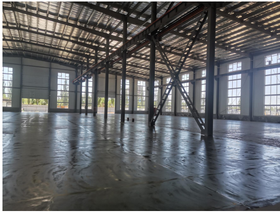
生产车间内部
