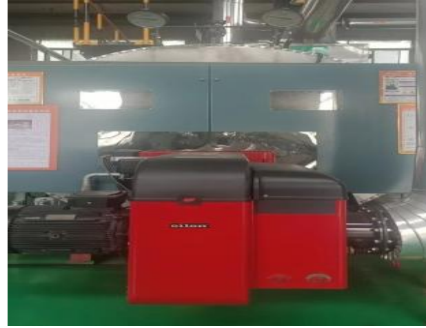
10t/h 天然气锅炉
