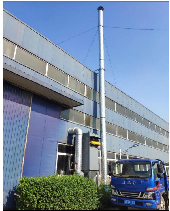
火焰切割、抛光烟尘、粉尘袋式除尘器
