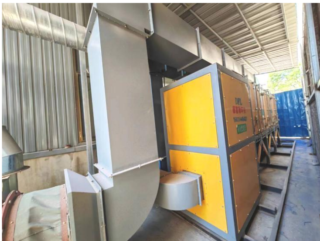
现有有机废气处理设备
